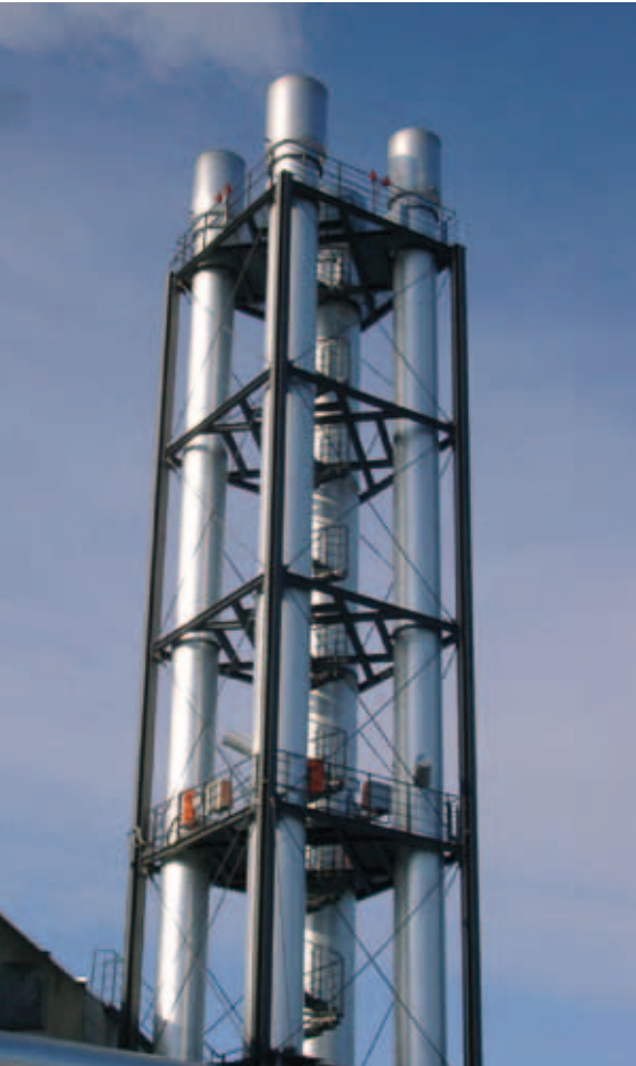
Kamine Kesselhaus der Technischen Zentrale
